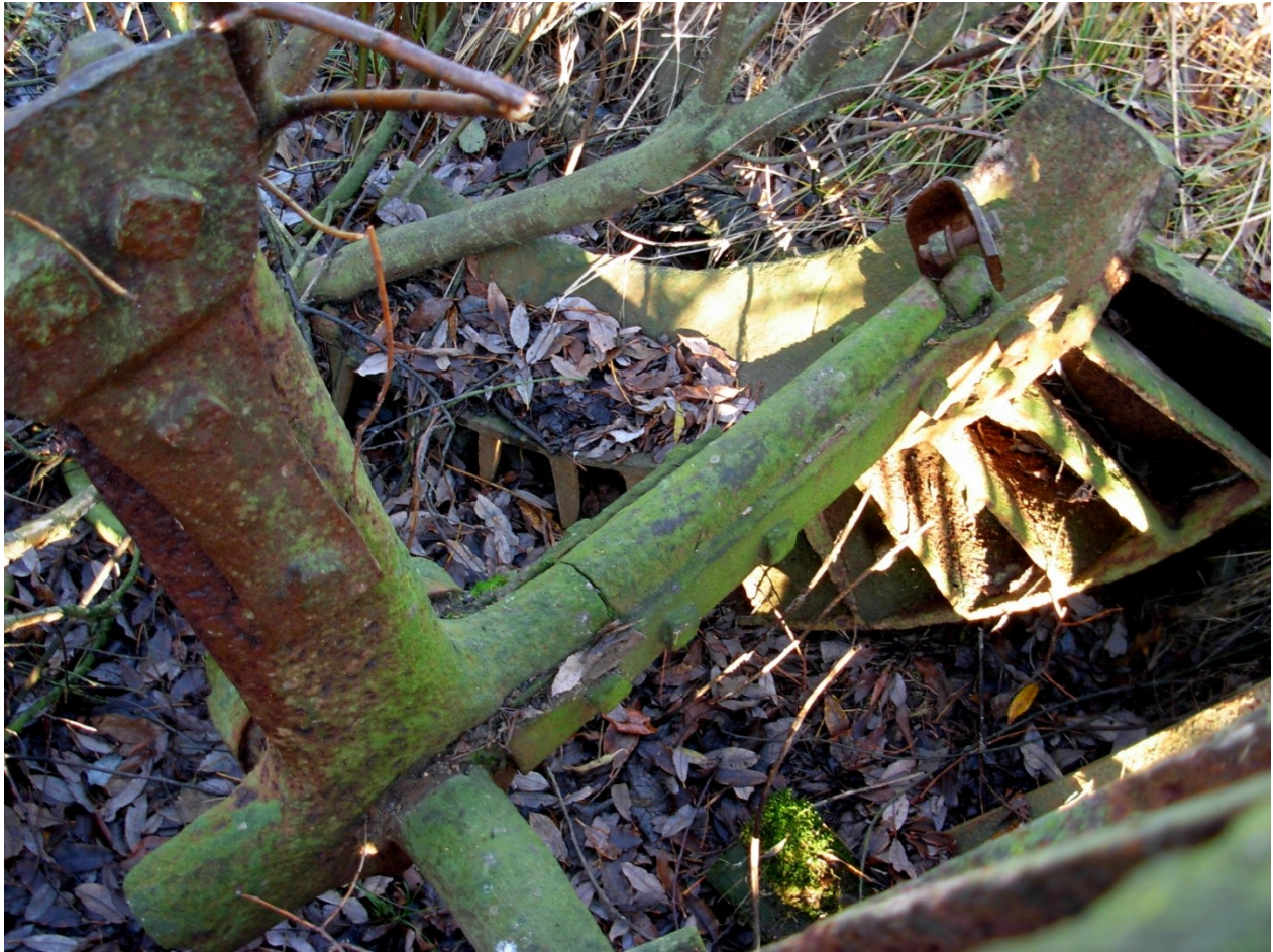
Del av turbinens löphjul och den skadade löphjulsekern.
